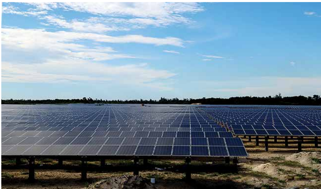
Dự án Điện mặt trời của Tập đoàn Hoàng Sơn tại xã Cẩm Hòa, huyện Cẩm Xuyên (Hà Tĩnh).
