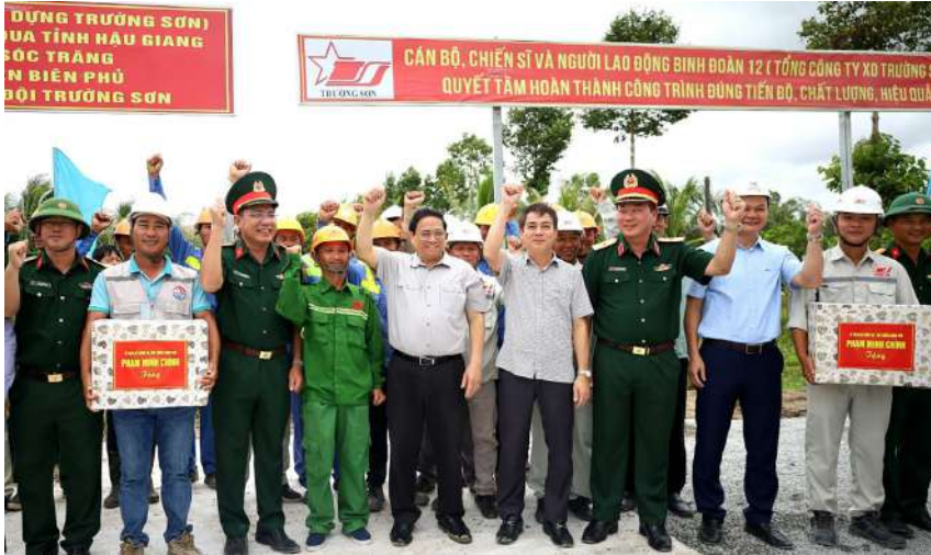
Thủ tướng Phạm Minh Chính thăm, động viên các đơn vị và công nhân thi công cao tốc Châu Đốc - Cần Thơ - Sóc Trăng.
